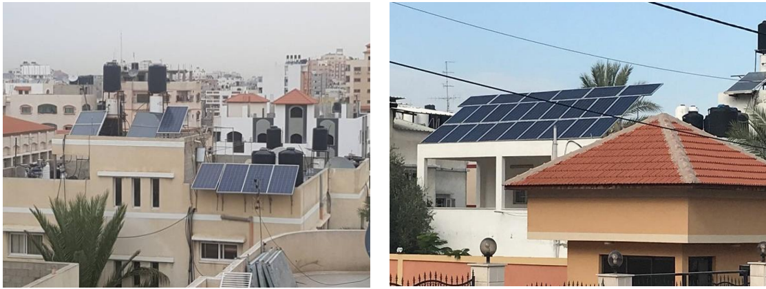
شكل (3.7): نماذج لبعض الوحدات الكهروضوئية المركبة على أسقف المباني في قطاع غزة
